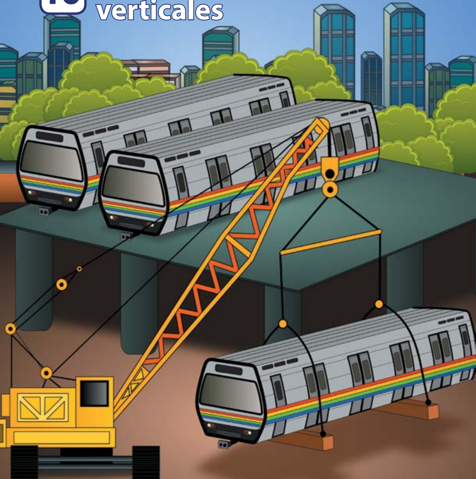
Grúa de desembarque de vagones del metro de Caracas
