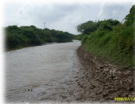
Ilustración 8 Vía de acceso inundada
