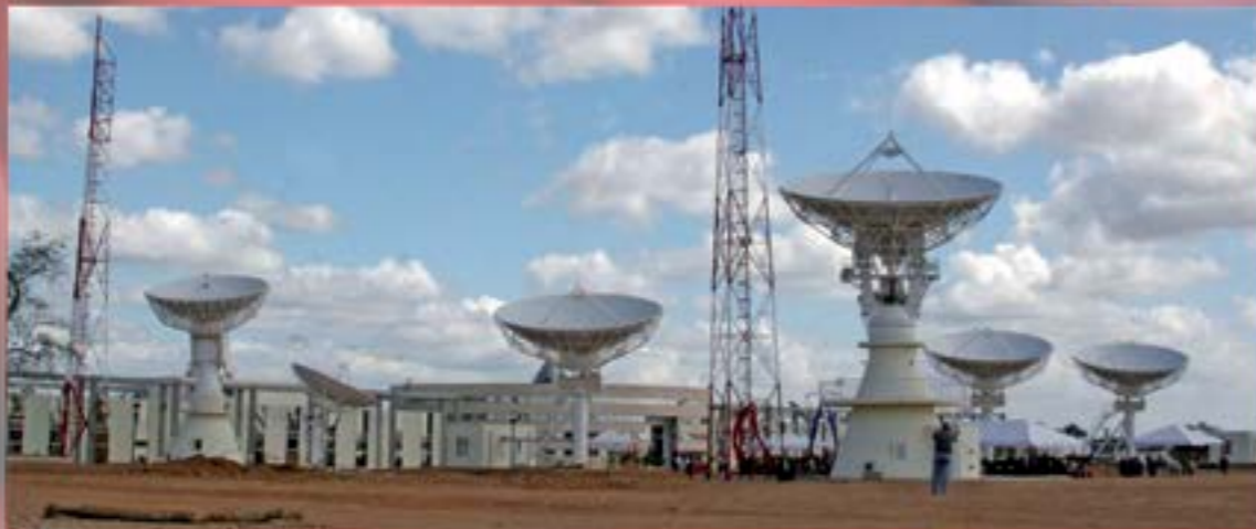
Estación terrena de control satelital "Manuel Rios". Bamarí, edo. Guárico.
