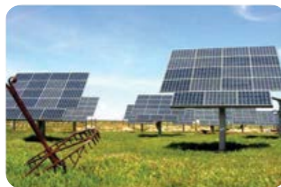
Figura 7.12. Paneles solares para generar energía eléctrica limpia.
