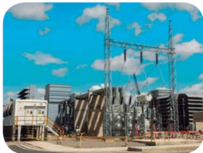
Figura 21.12. Central Termoeléctrica Josefa Camejo, ubicada en el estado Falcón, Venezuela.
