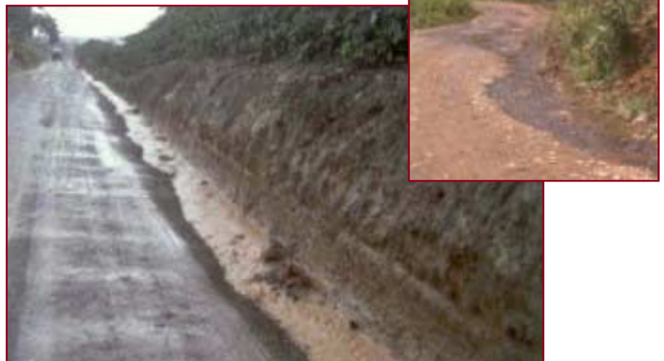
Figura 1. Socavamiento de cunetas por falta de mantenimiento periódico.
