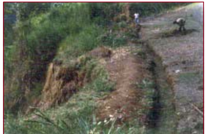
Figura 11. Canal de corona con cobertura de pasto grama ( Paspalum conjugatum ) para desviar flujo de agua por escorrentía en el control de negativo de carretera. (Cenicafé, Chinchiná, diciembre de 1993).
