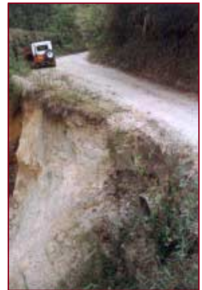
Figura 8. Formación de negativo de carretera por obras inconclusas
