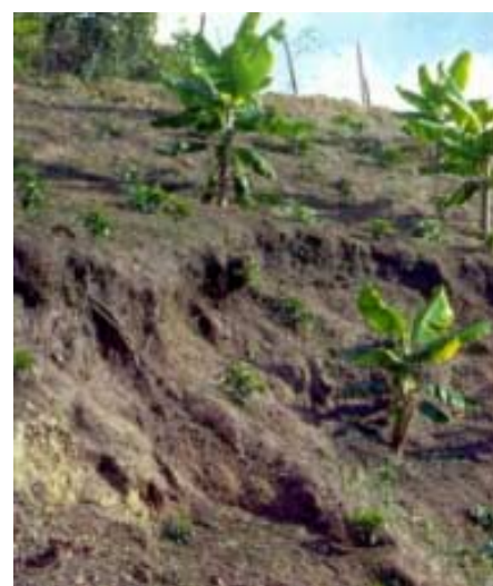
2 Suelo removido por el azadón y arrastrado por las aguas lluvias.
