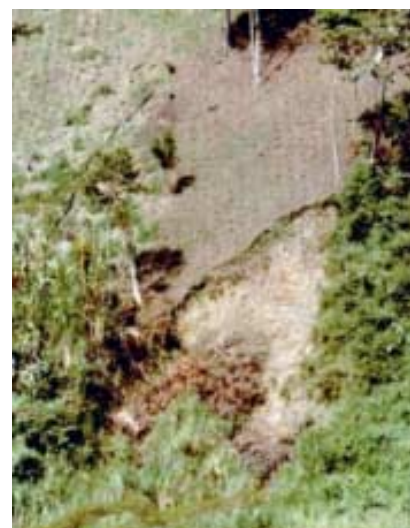
5 Suelo erosionado en el cual se observa el material parental.
