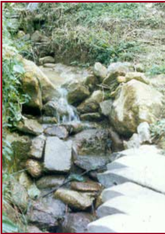
Figura 9. Drenaje natural con protección de su cauce con piedra acomodada, para evitar socavamientos de fondo y de los taludes.
